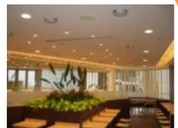
LED照明の導入例
