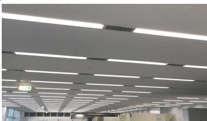
省エネルギー事例（照明器具のLED化）
