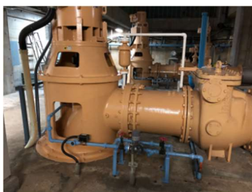
汚水ポンプ設備
