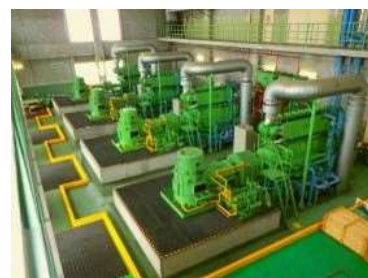
雨水ポンプ設備
