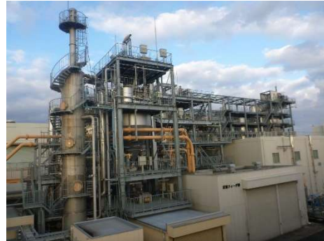
次世代型汚泥焼却炉
