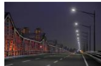
LED 道路照明
