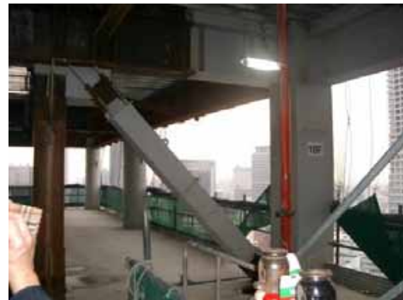
鋼材系ダンパーの設置例
