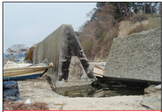
押し波により防潮堤が陸側に倒壊
