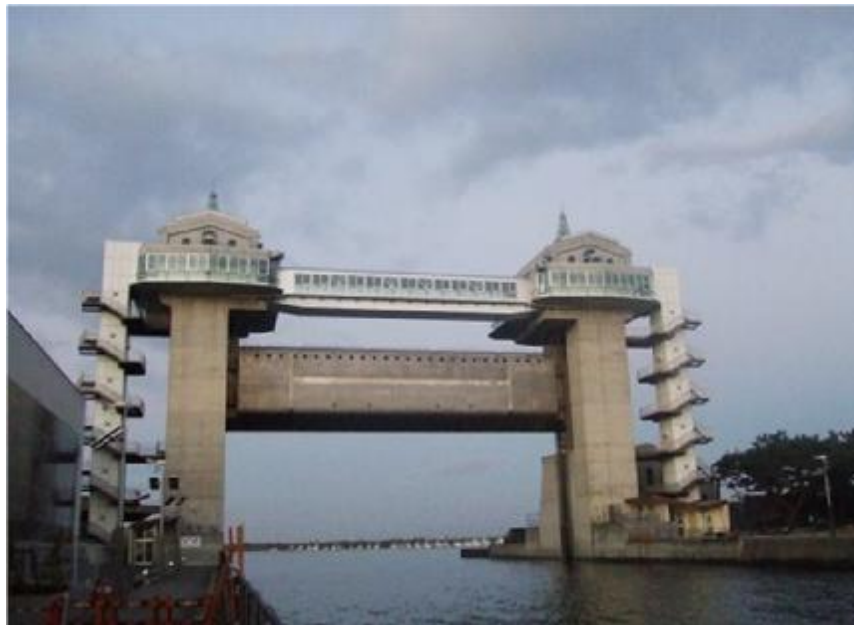
津波用水門(参考 静岡県沼津市『びゅうお』) 幅40m、高さ9.3m、重さ406t
