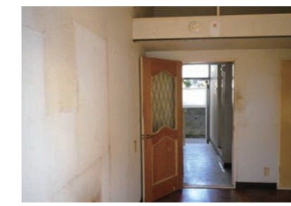
壁のタバコ等のヤニ 通常の使用による損耗を超える⇒ 借主負担
