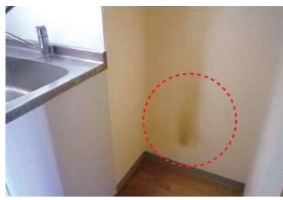
冷蔵庫の後部壁面の黒ずみ(電気ヤケ) 通常の使用による損耗⇒ 貸主負担
