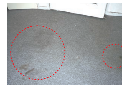
飲み物等をこぼしたことによるカーペットのシミ 手入れ不足等で生じたもの⇒ 借主負担
