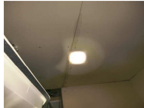
ユニットバス天井裏水浸み
