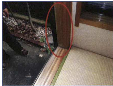
和室東側窓 敷居等に染み
