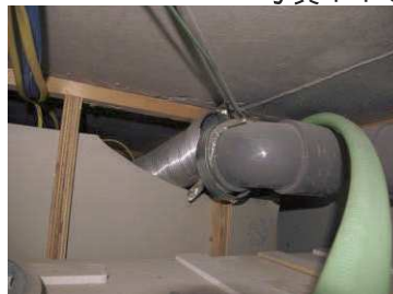
ダクト配管の確認
