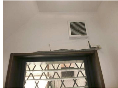
1階トイレ換気扇まわりからの雨漏れ
