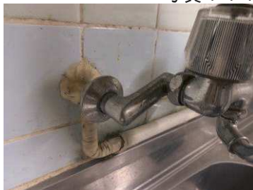
給水管の漏水確認
