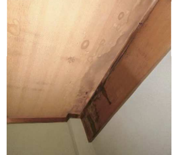
天井の雨漏り跡
