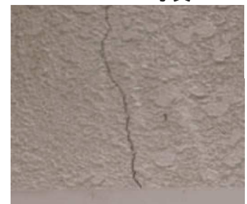
壁のひび割れ
