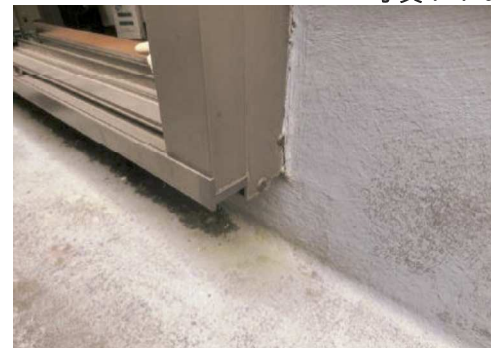
FRP防水の窓際に切れ及び浮きあり
