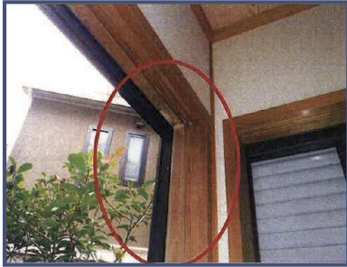
和室東側窓 鴨居等に染み
