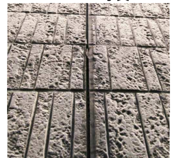
目地シールの劣化
