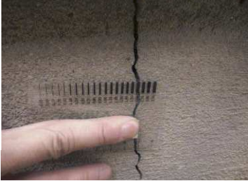
ひび割れの確認（クラックスケール）
