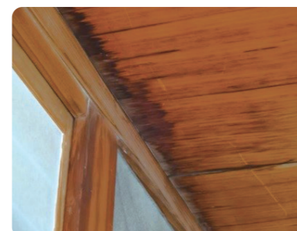
雨漏り跡調査
