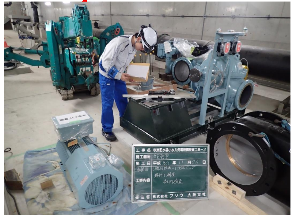
小型クレーン設備
