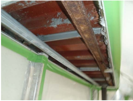
廊下側（北側）アスベスト付着状況
