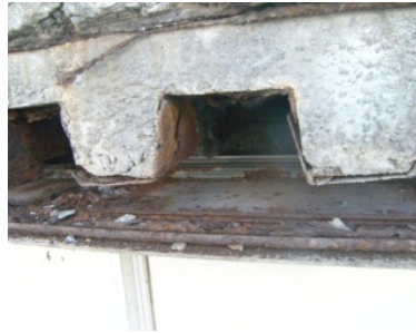
1 軒先腐食確認(南面3階X10~11)
