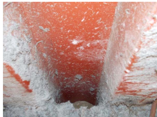
教室側（南側）アスベスト付着状況（拡大）
