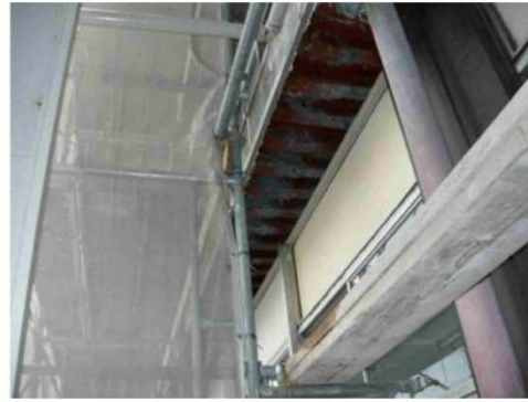
アスベスト付着状況 (Aゾーン俯瞰)
