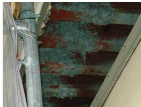
アスベスト付着状況 (Aゾーン拡大)
