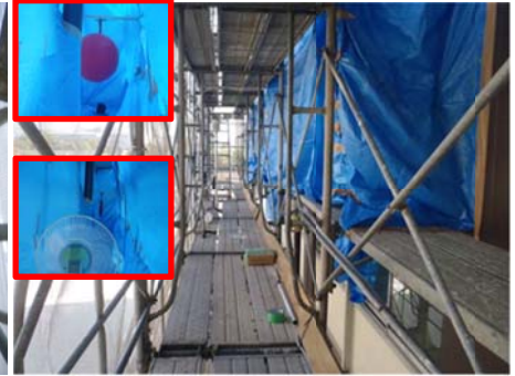
ブルーシートと内部の状況
