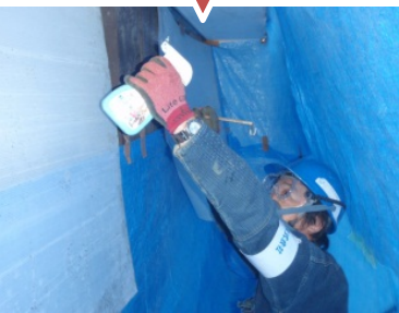
6 ケイカル板湿潤状況
