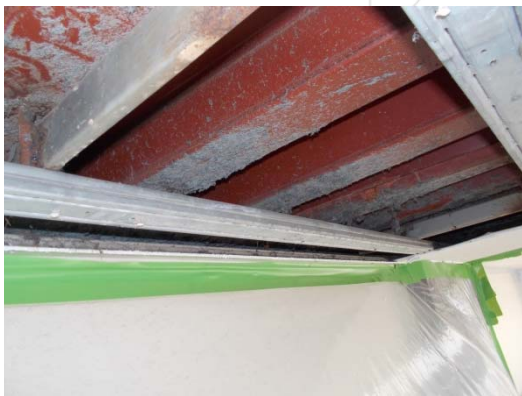
教室側（南側）アスベスト付着状況（俯瞰）
