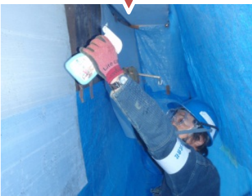
6 ケイカル板湿潤状況
