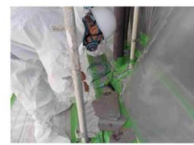
測定点2-1付近 ボード付着物確認
