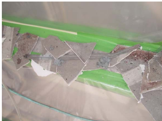
教室側（南側）アスベスト付着状況（庇裏ボード）
