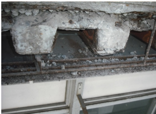
アスベスト付着状況 (Bゾーン拡大)
