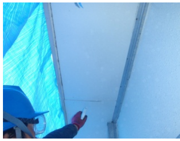
7 ケイカル板湿潤状況
