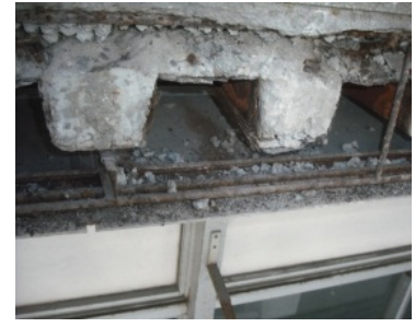
2 軒先腐食確認(南面2階X7~8)
