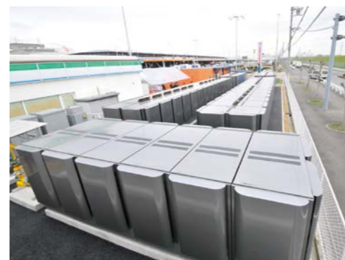
1.2兆瓦燃料电池 (SOFC) (2015年3月开始提供)
