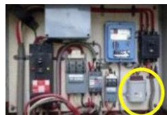
低圧分電盤内の 低圧コンデンサー
