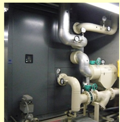
吸収式冷温水機
