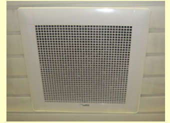
エアコンや給気口の目詰まり
