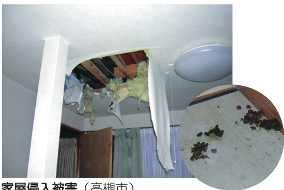
家屋侵入被害 （高槻市） 天井が破られ、床に糞
