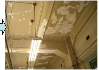
天井の塗装はがれ
