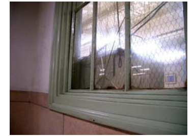
窓ガラスの破損
