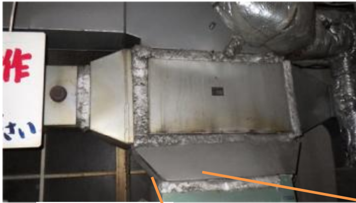
脱臭装置の一部
