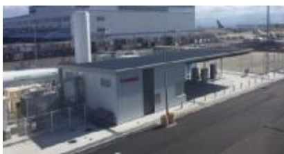
○産業車両用大規模水素供給施設
