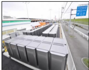
○中央卸売市場の燃料電池
