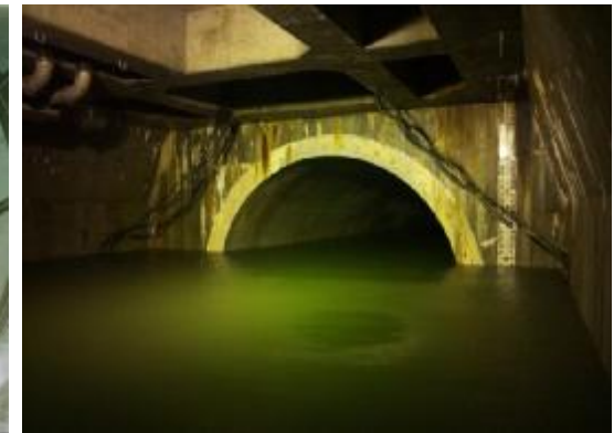
寝屋川南部地下河川(今川立坑貯留状況)H23.8
