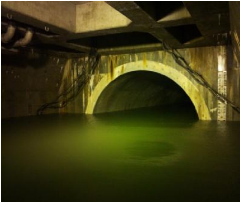
貯留時の状況
