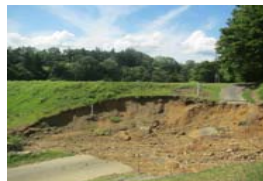
平成30年7月豪雨により被災したため池
