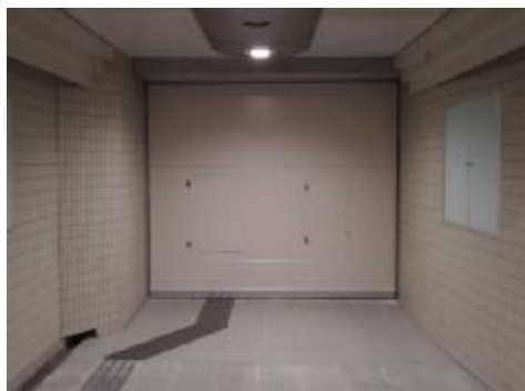
地下駅の浸水対策 (止水扉の設置)
