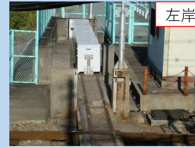
阪急神戸線防潮鉄扉
