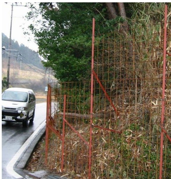
斜面に応じて高さを変えているワイヤーメッシュ柵
